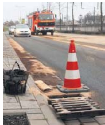
Offener Gulli: Der Regenwasserkanal muss gereinigt werden.
